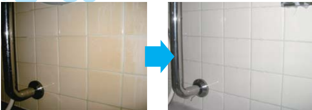
介護施設浴室壁面 導入後、タイルの汚れがみるみる落ちました!
