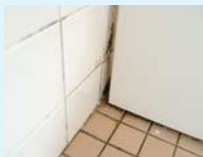
洗浄しにくい隙間には、汚れ、カビが。洗浄するには細いブラシなど専用ツールが必要…
